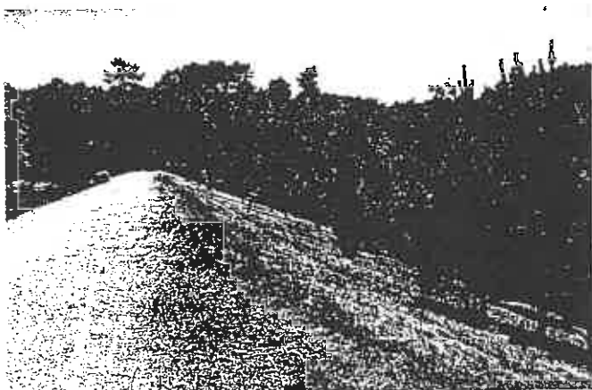
Talus aval non entretenu
